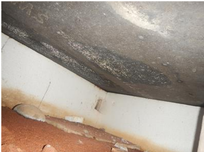
Mikrobiell påväxt och kondens på blindbotten i äldre del kryppgrund.
