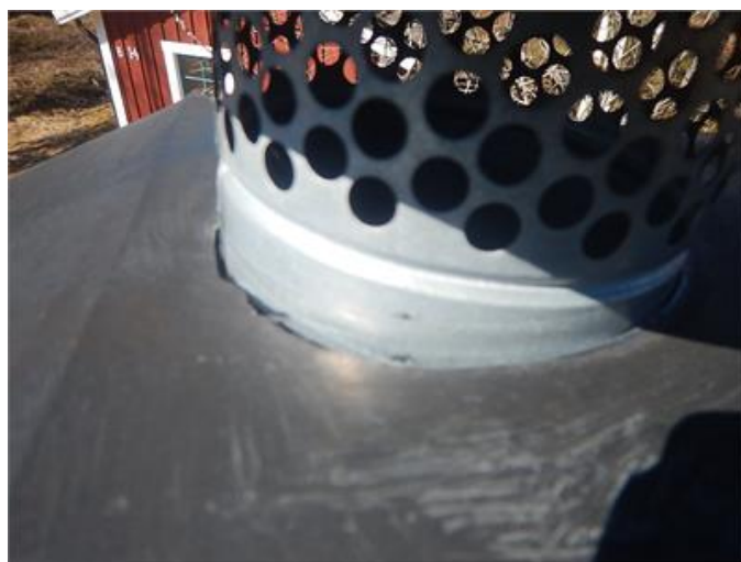
Otätthet mellan ventilationshuv och rör.
