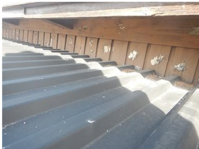
Plåt som ej finns mellan husvägg/tak uterum.
