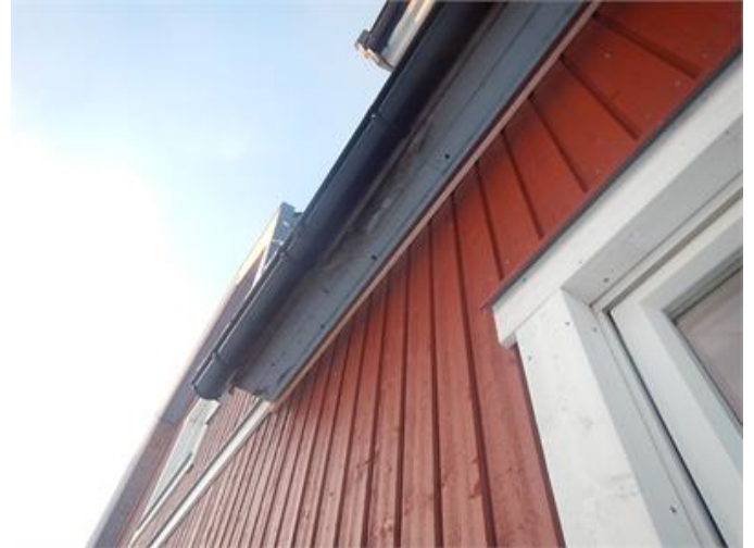
Färgsläpp i takfot baksida.
