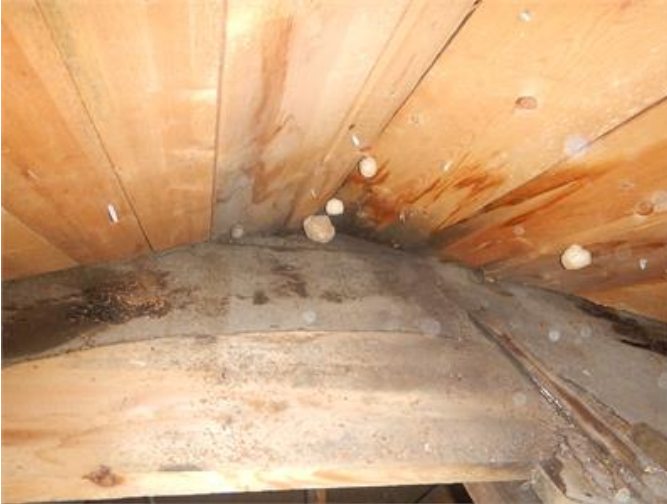
Fuktpåverkan på underlagstak vind.
