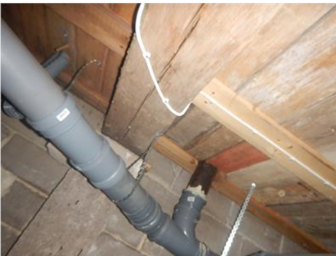
Mikrobiell påväxt på blindbotten krypgrund.
