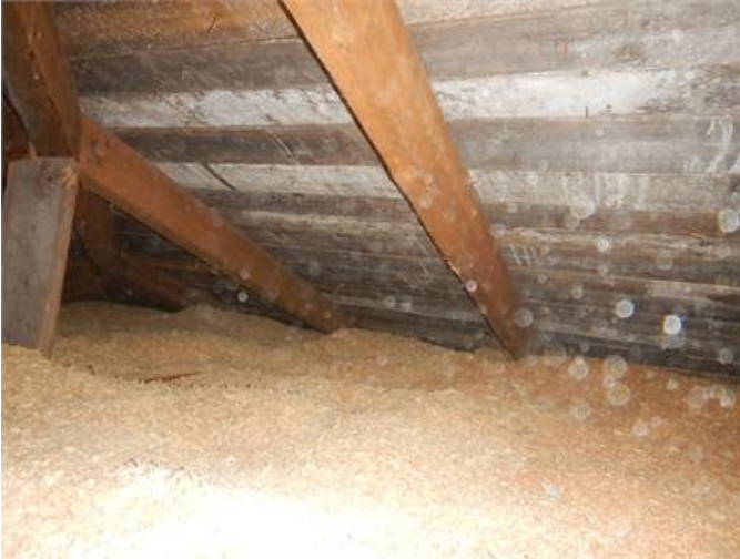
Mikrobiell påväxt noteras på underlagstak vind.
