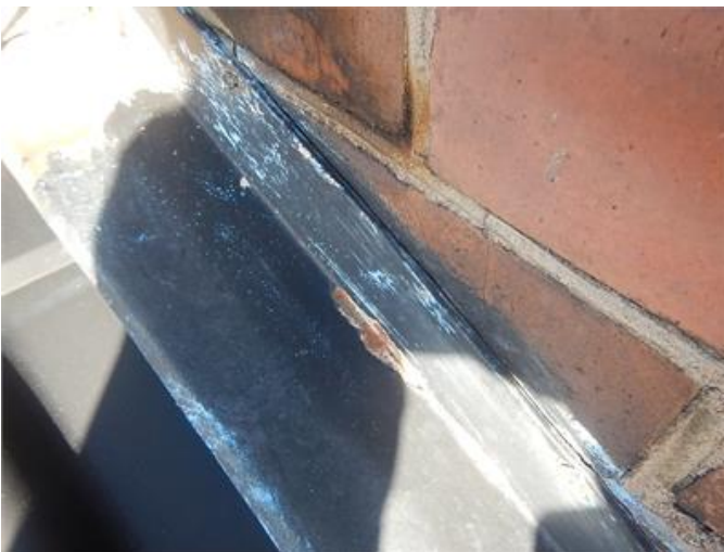
Otätthet mellan murstock och skorstensbeslag.
